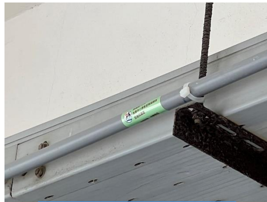
管路識別標示
